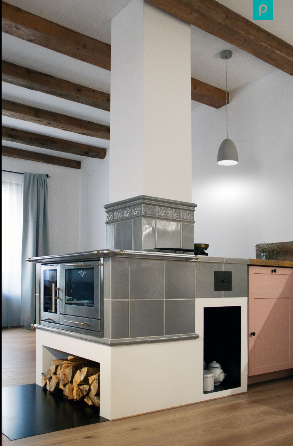
Bausatzherd 100XL Panorama, mit Kacheln verkleidet und Sockel in Mauerwerk
